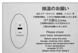
【共用部入口の検温器設置】
